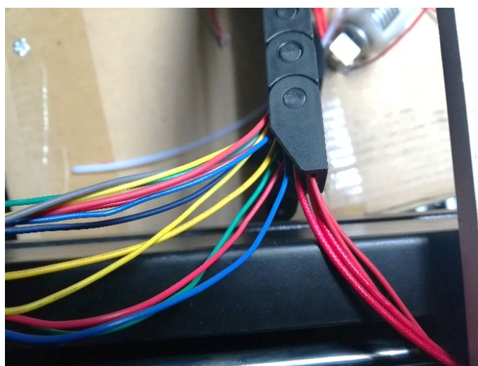
Figura 142. Cableado por cadena flexible
