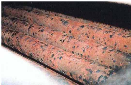
Figura 16. Corrosión por oxígeno en calderos.
