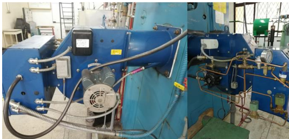
Figura 26. Quemador Power Flame
