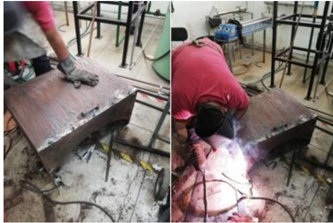
Figura 35. Reemplazo de los pernos de sujeción de las tapas móviles del lado de fuego
