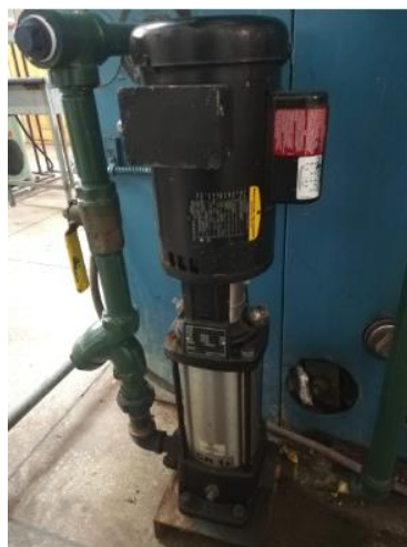
Figura 19. Bomba de alimentación de combustible
