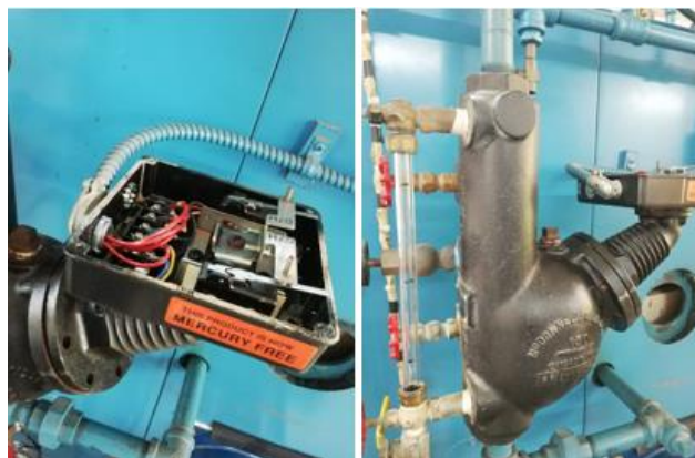
Figura 38. Controlador del Mc Donnell and Miller
