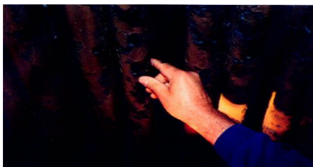
Figura 15. Incrustaciones en tubos de intercambio de calor
