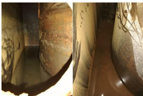
Figura 39. Tanque de condensado
