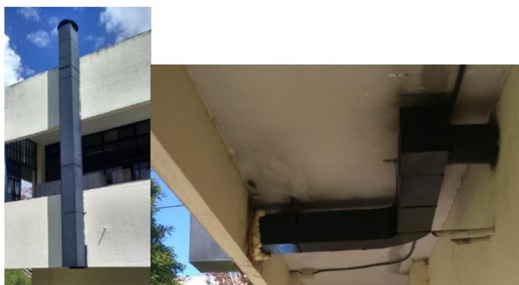
Figura 25. Chimenea del caldero York Shipley
