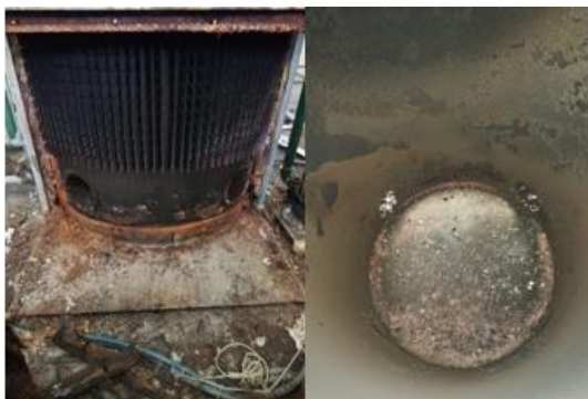
Figura 34. Salida de gases de combustión
