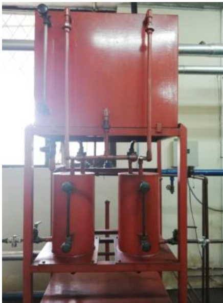
Figura 18. Tanque de almacenamiento de combustible
