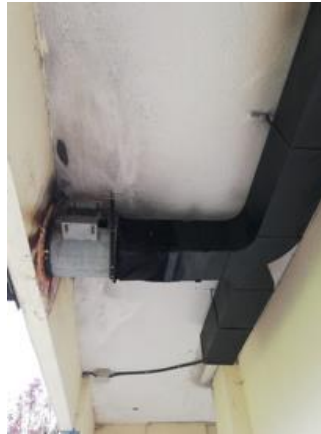
Figura 36. Ducto de salida de gases de combustión, acoplado con ventilador
