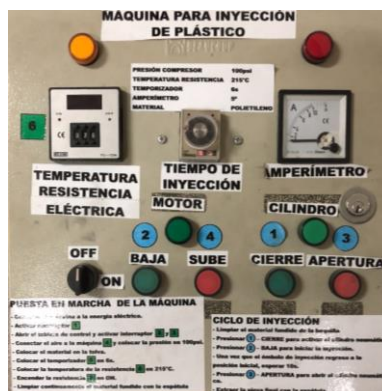
Figura 2. Exterior del Tablero de control
