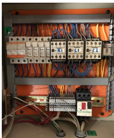
Figura 3. Interior del Tablero de control
