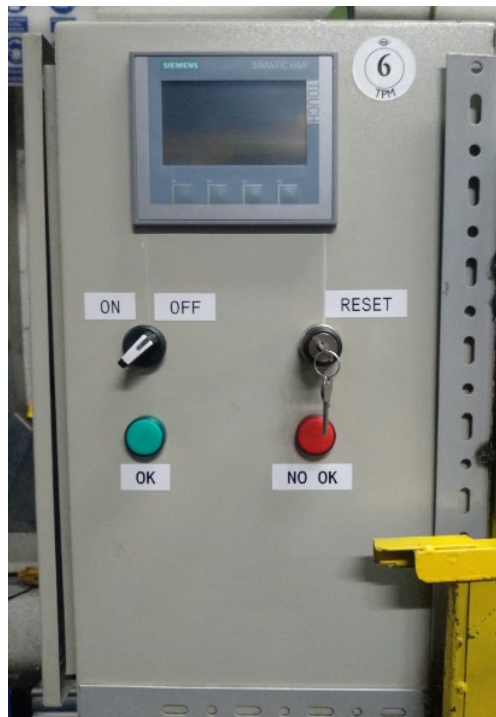
Figura 108. Exterior gabinete de control taladro Leland automatizado
