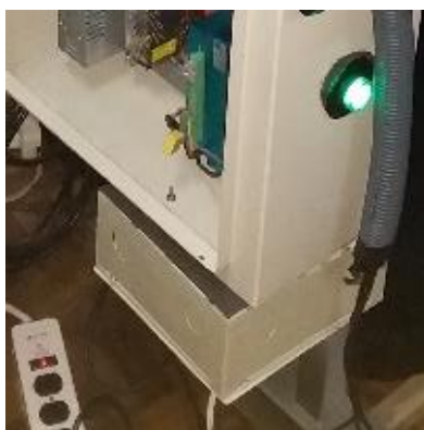
Figura 90 Caja de circuito de protección
