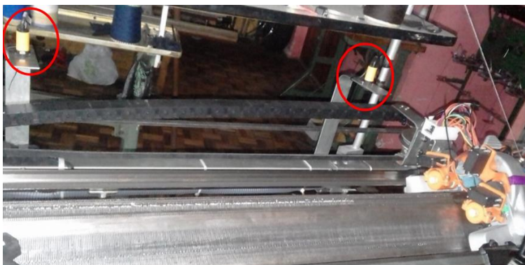
Figura 84 Sensores capacitivos montados sobre la base de la trasmisión de movimiento del carro.
