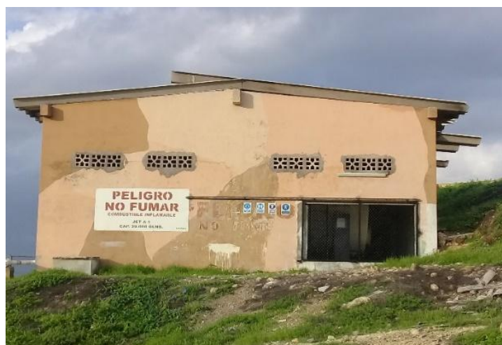
Figura 17. Tanque de Combustible
