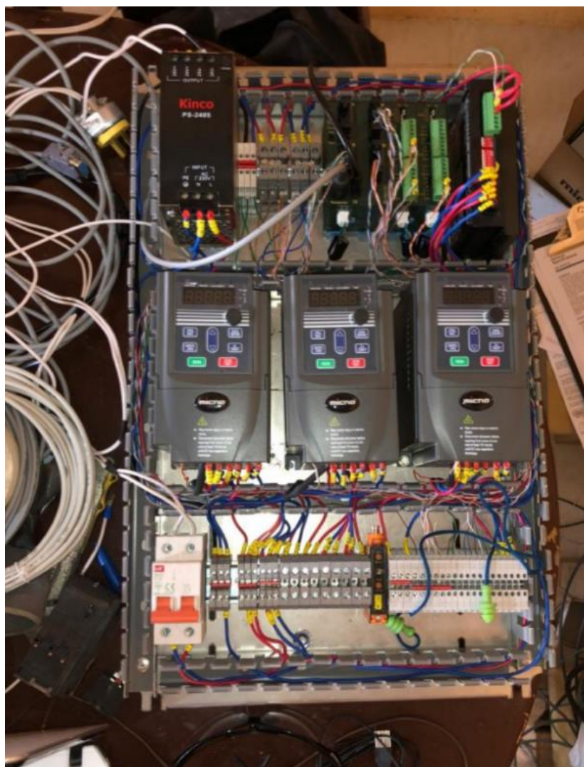
Figura 35. Cableado tablero de control de la máquina etiquetadora
