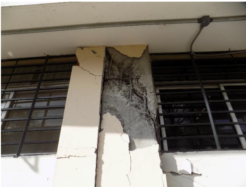
Figura 17. Falla por columna corta Cortesía: Ing. Pablo Caiza, Ph. D.
