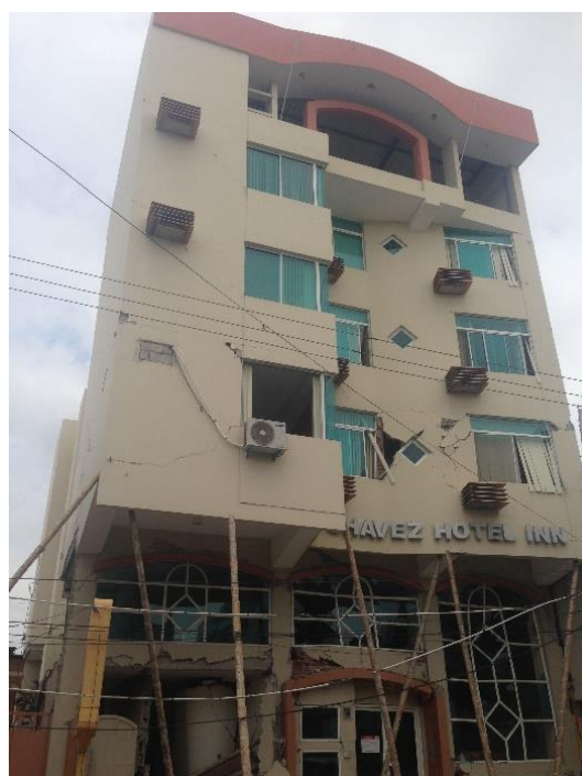
Figura 1. Edificación mal apuntalada Fuente: (EERI, 2016)
