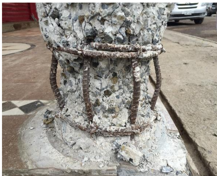
Figura 3. Falla de columna por compresión Fuente: (EERI, 2016)
