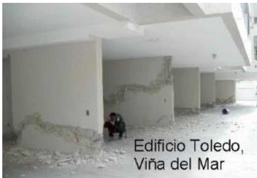
Figura 12. Falla en muro por flexión Fuente: (Á. San Bartolomé et al., 2011)
