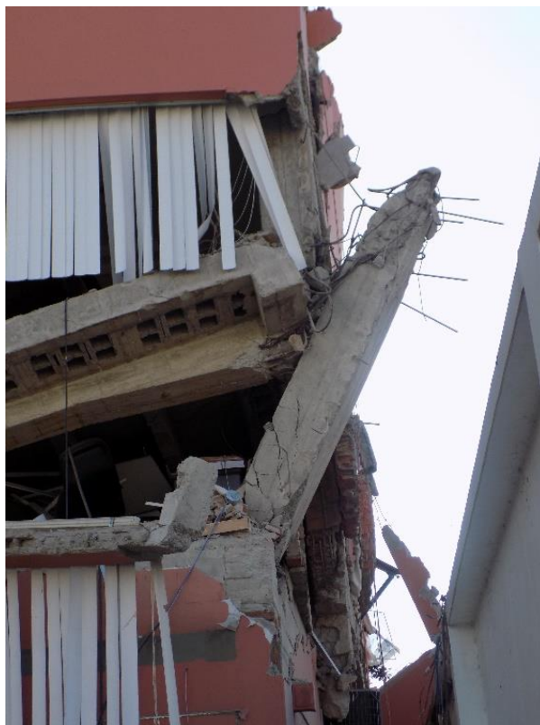
Figura 14. Falla en uniones viga-columna Cortesía: Ing. Pablo Caiza, Ph. D.
