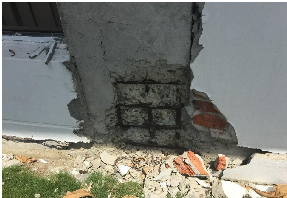
Figura 7. Pérdida de recubrimiento Fuente: (EERI, 2016)
