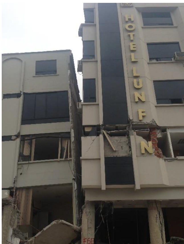
Figura 18. Golpeteo entre edificaciones Fuente: (EERI, 2016)
