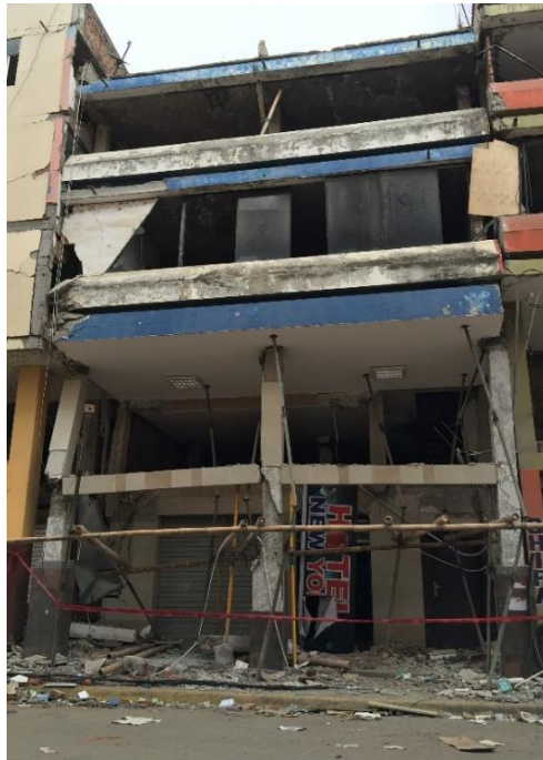
Figura 97. Daño estructurales del pórtico frontal Fuente: (Lanning et al., 2016)
