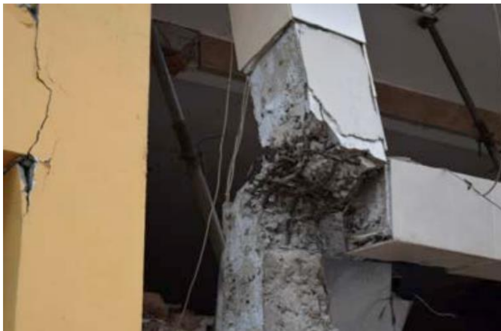
Figura 74. Fallo en la conexión viga-columna.
