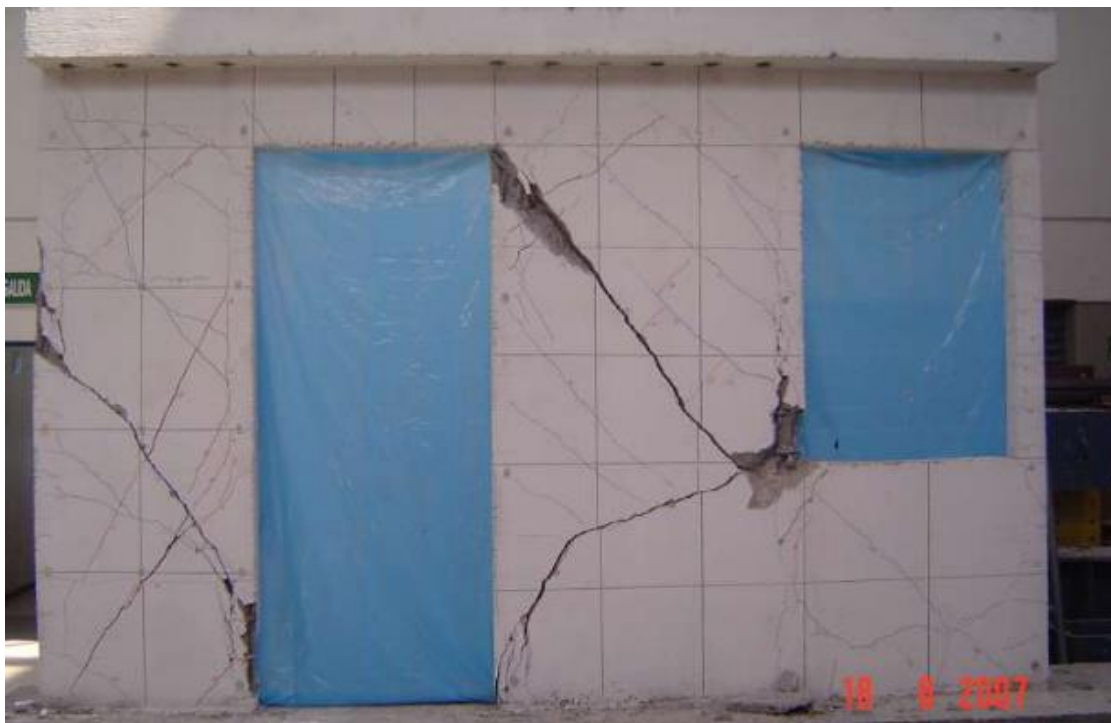
Figura 11. Falla en muro por tensión diagonal Fuente: (CNPCM, 2016)
