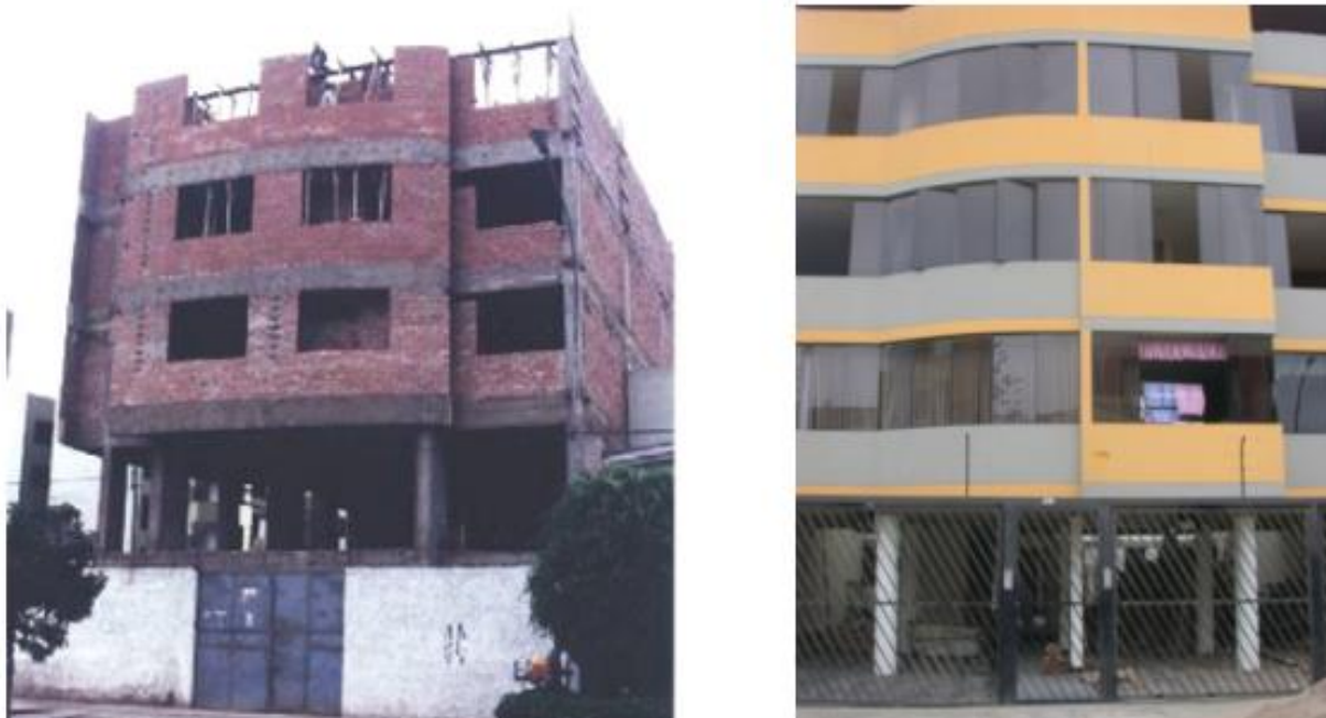
Figura 16. Edificaciones con piso blando Fuente: (A. San Bartolomé, 2010)
