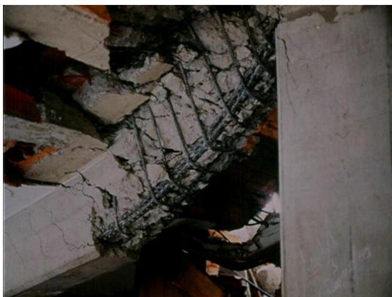
Figura 9. Falla por flexión en viga Fuente: (Sambrano, 2015)
