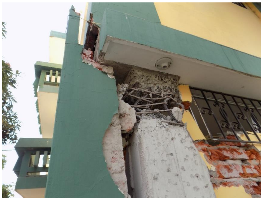
Figura 5. Falla de columna por flexo compresión Cortesía: Ing. Pablo Caiza, Ph. D.
