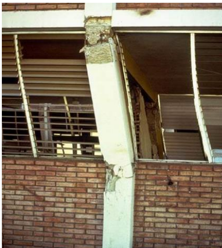
Figura 4. Falla de columna por flexión Fuente: (CNPCM, 2016b)
