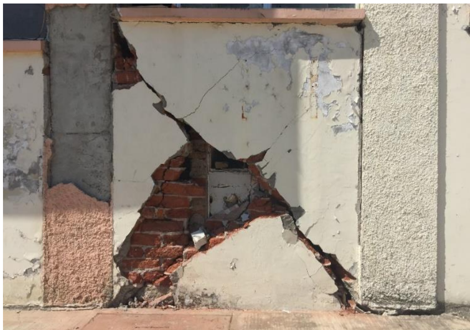
Figura 13. Falla en muro debido a tensión diagonal por cortante Cortesía: Ing. Pablo Caiza, Ph. D.
