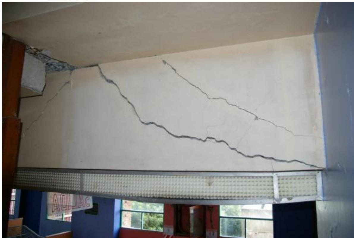
Figura 8. Falla por cortante en viga Fuente: (UCR, 2012)
