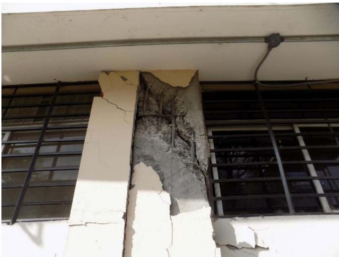
Figura 6. Falla de columna por cortante Cortesía: Ing. Pablo Caiza, Ph. D.
