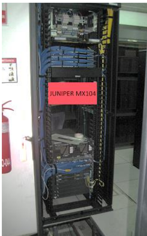
Figura 56. Posición del equipo MX104 en rack indoor existente
