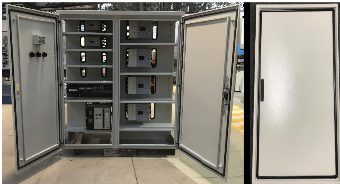
Figura 71. Empaque en puertas frontales, laterales y traseras de gabinete de distribución
