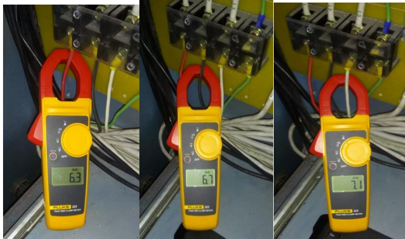
Figura 48. Corriente medida las líneas de alimentación trifásica de la máquina
