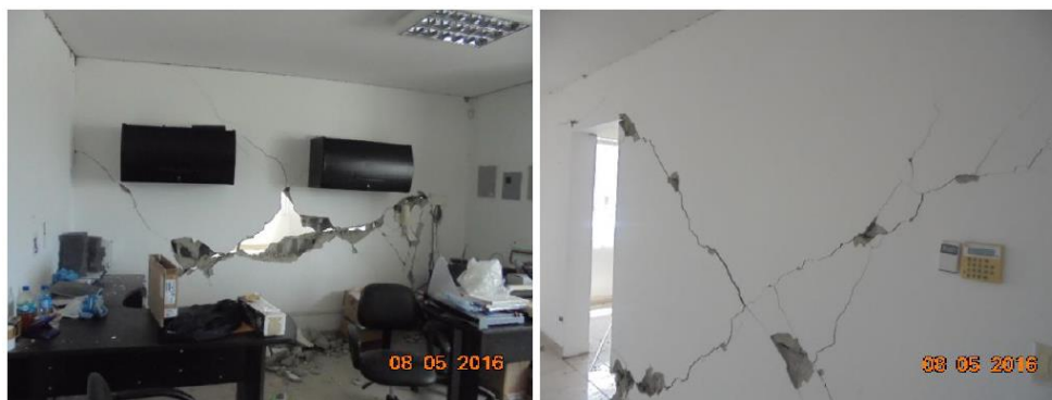
Figura 2. Rotura y Rajadura de mampostería de bloque edificio Fortaleza Fuente: (Aguiar, Del Castillo, Mizobe, & Mendoza, 2016)
