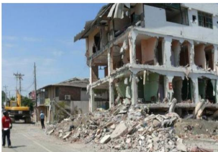
Figura 1. Falla por volcamiento de mampostería después del terremoto del 16 de abril de 2016 Fuente: (El Comercio, 2016)
