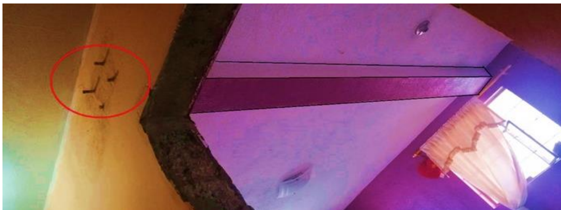
Figura 4. Discontinuidad de una viga principal, error producido por no contar con detalles en los planos
