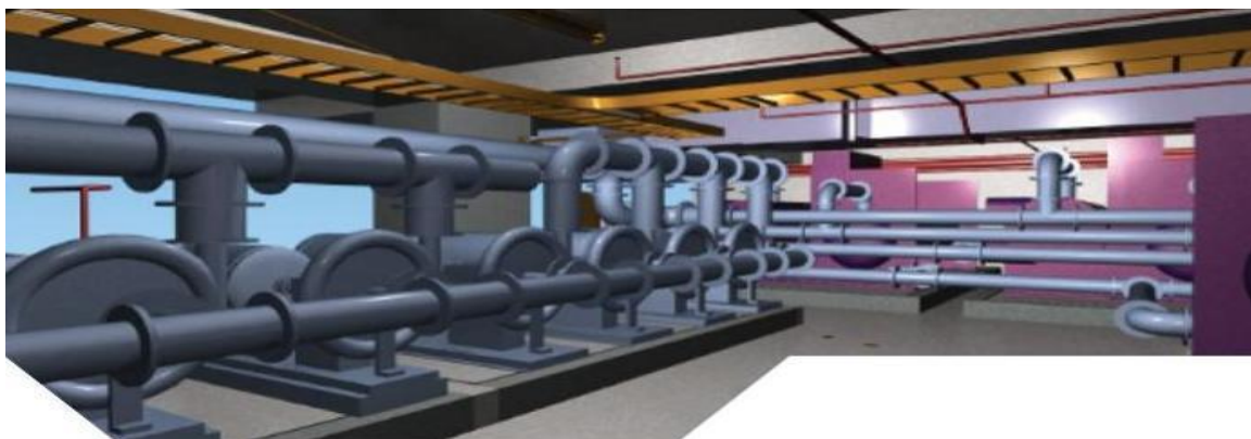
Figura 15. Cuarto de Máquinas: Instalaciones Sanitarias, Mecánicas, Eléctricas y Cableado Estructurado Fuente: (Fuentes Hurtado, 2017)
