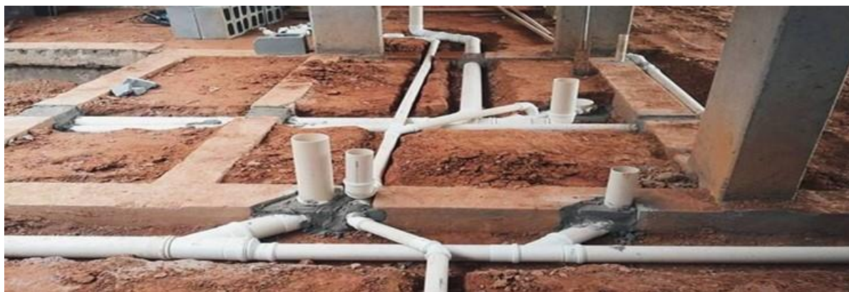
Figura 19. Colisión entre la cadena de cimentación y la tubería PVC de aguas servidas en la edificación
