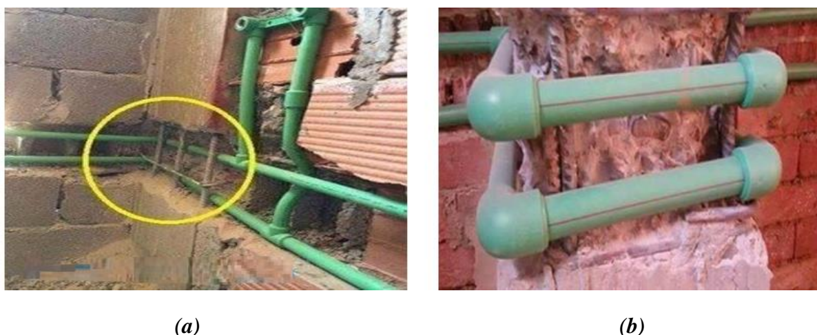
Figura 18. Colisión entre columna y tuberías, la tubería traspasa la columna ( a ) la columna es confinada por la tubería ( b ) Fuente: (Our Story, 2018)
