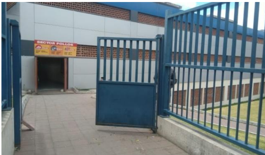
Figura 28. Debilidades de Seguridad del acceso 22 del "Nuevo Mercado 24 de Mayo"
