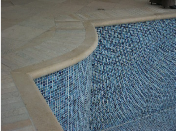
Gráfico N° 18 Instalación en piscina
