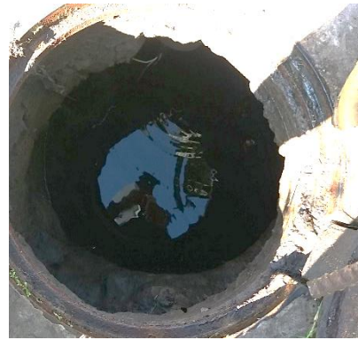
b.- Pozo colapsado
