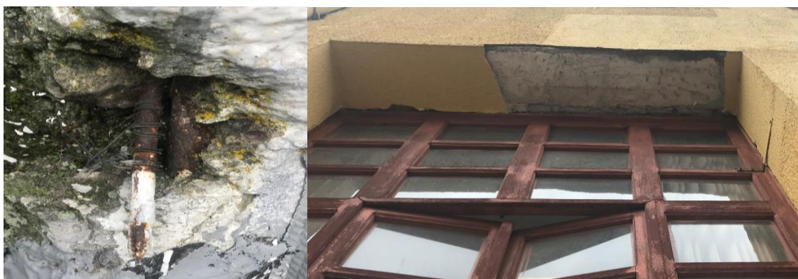
e) Por malas prácticas constructivas
