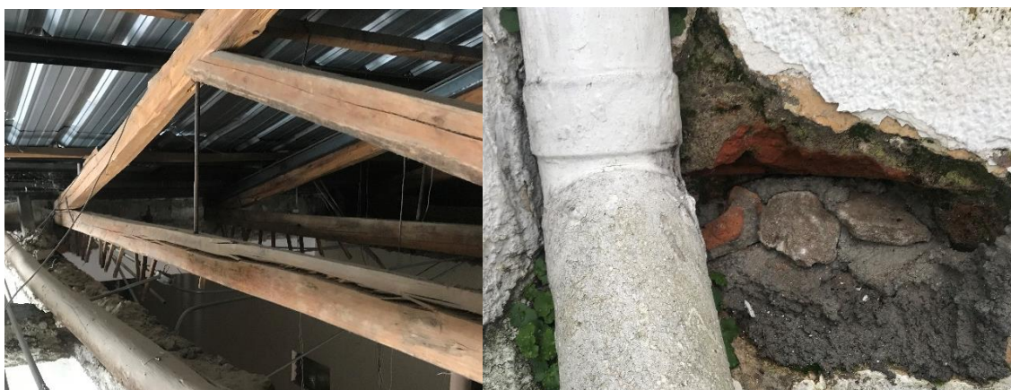
c) Por malas técnicas constructivas
