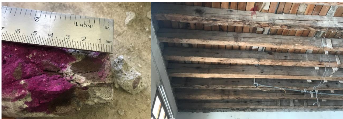
a) Por carbonatación del hormigón
