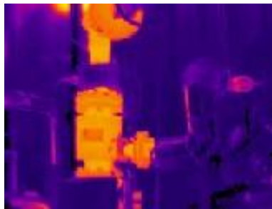
Fig.5.7. Termografía en válvulas.
