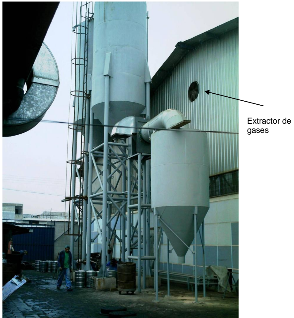
Foto E28.- Equipo de extracción de gases
