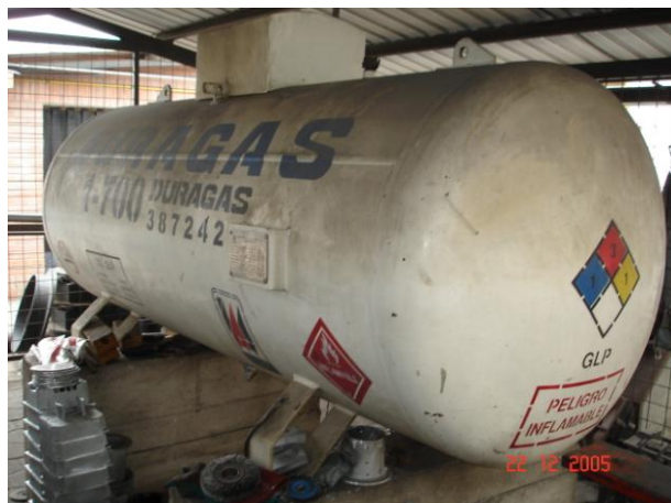
Foto E3.- Equipo de suministro de gas (bomba de gas)
