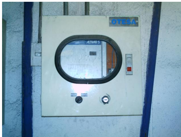
Foto E29.- Equipo de extracción de gases (tablero de control)
