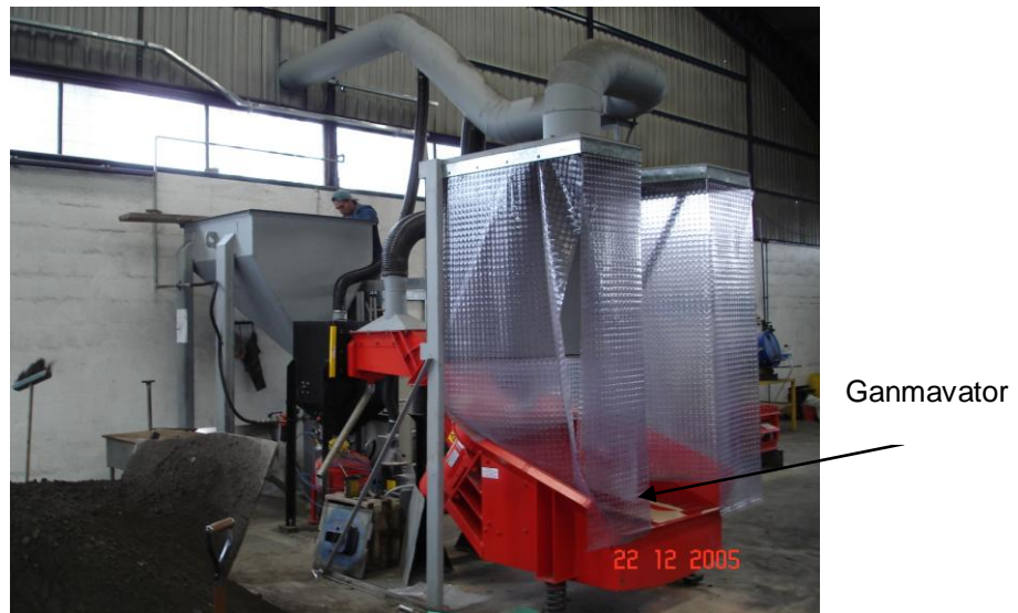
Foto E15.- Equipo de recuperación de arena (interior)
