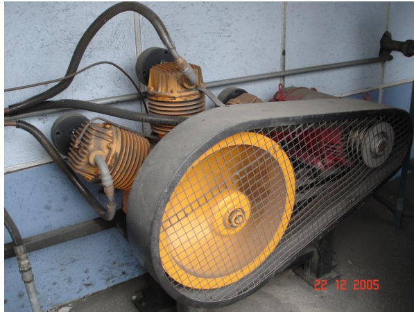
Foto F1.- Compresor
