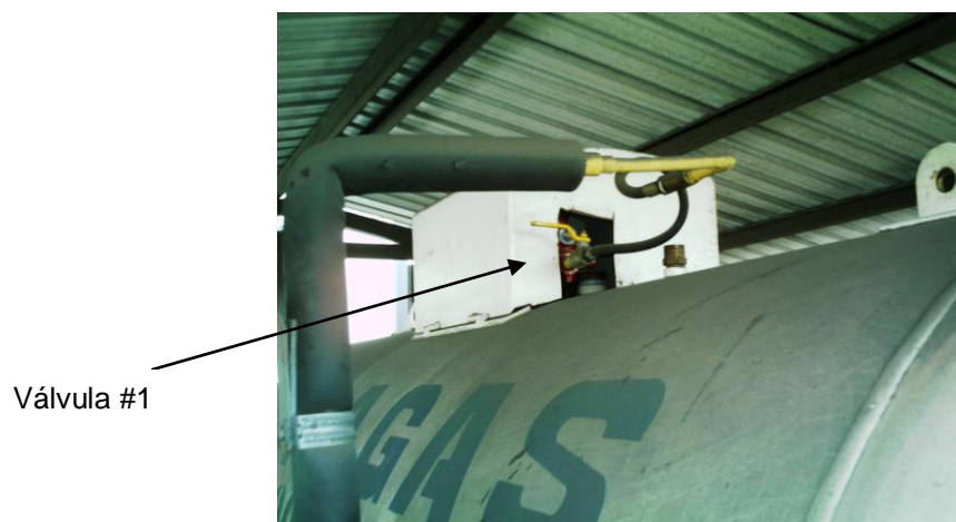
Foto E5.- Equipo de suministro de gas (válvula)
