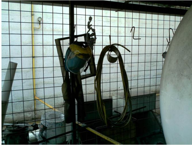
Foto E6.- Equipo de suministro de gas (línea de gas)
