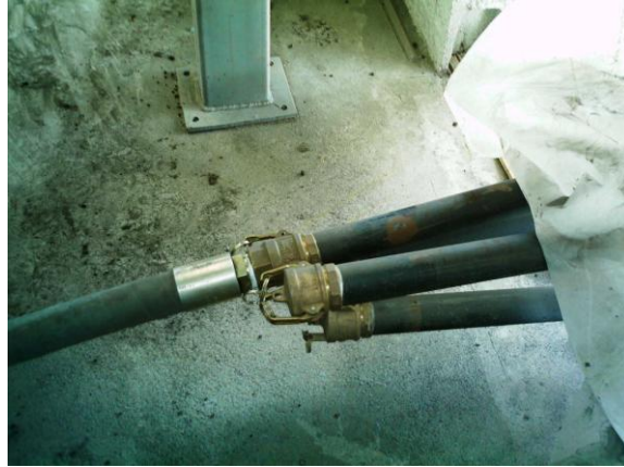
Foto F4.- Conexiones a los silos.
