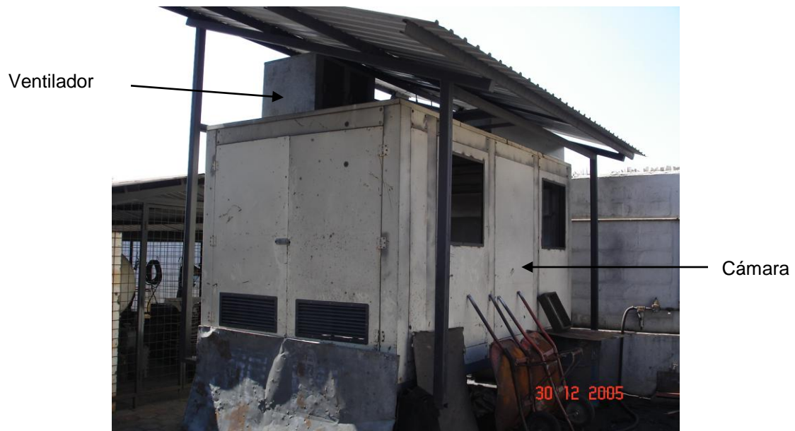
Foto F14.- Cámara de sandblasting.
