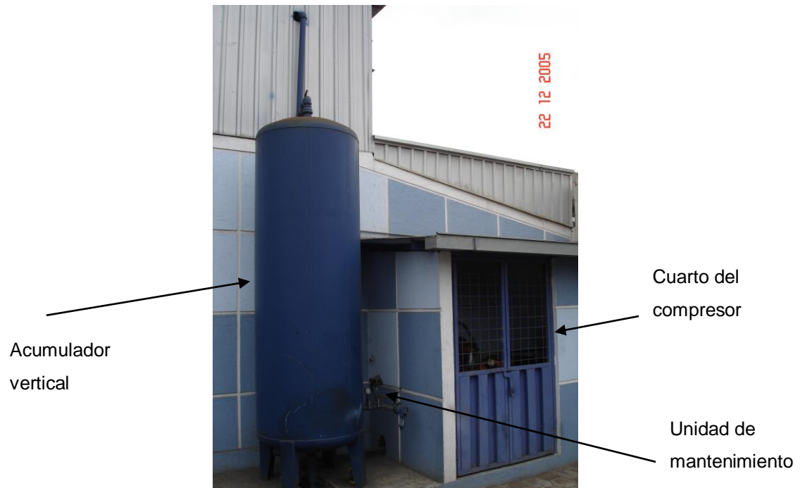
Foto E1.- Equipo de suministro de aire comprimido
