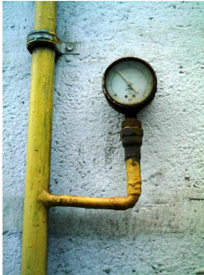
Foto E7.- Equipo de suministro de gas (manómetro #1)
