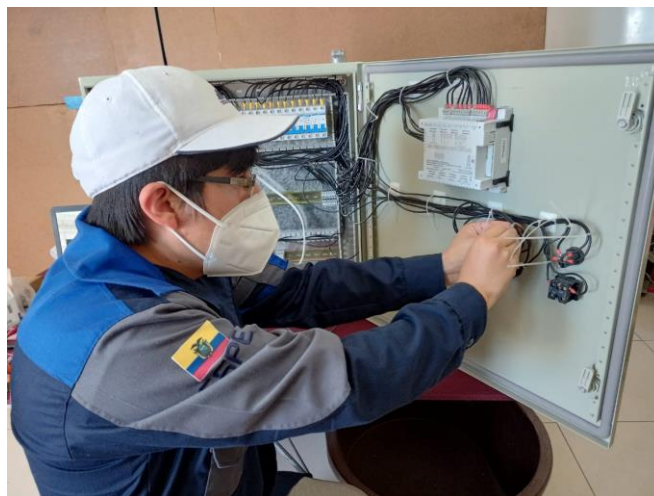
Cableado del Armario del Operador
