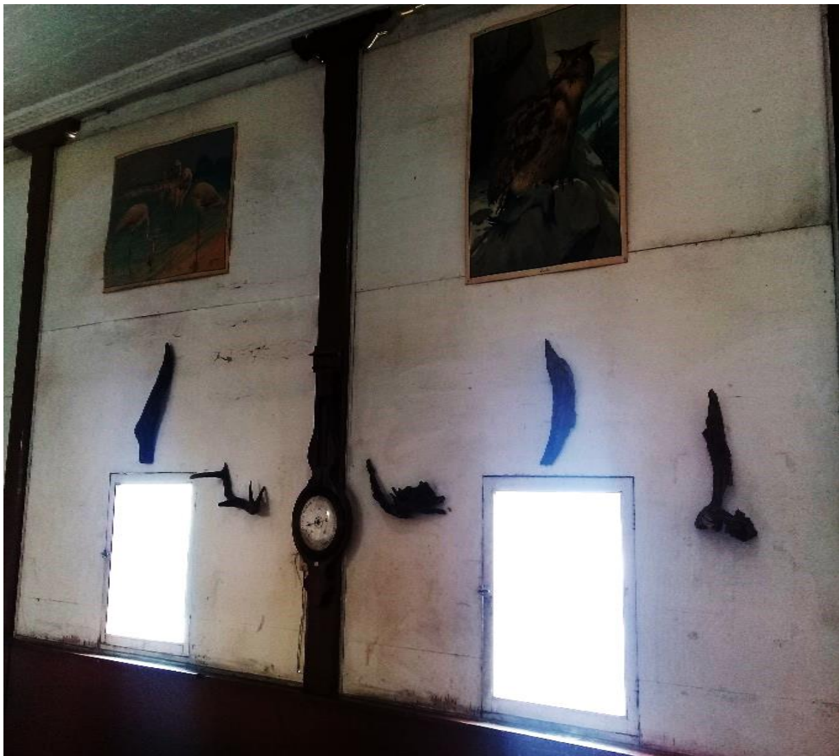
Sala de Instrumentos Antiguos de Física Ventana con pintura cuarteada y paredes manchadas
