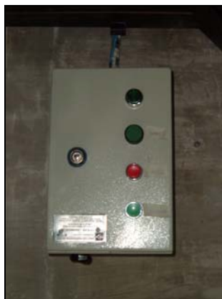
Figura. 5.2 Tablero de Control Auxiliar
