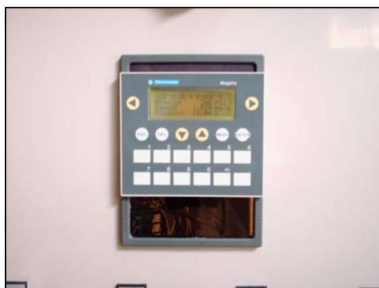
Figura. 5.14 Magelis en Tablero de Control
