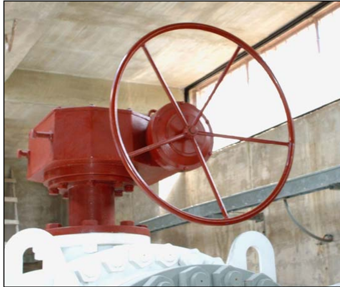
Figura. 2.47. Actuador de Válvula Esférica de By Pass
