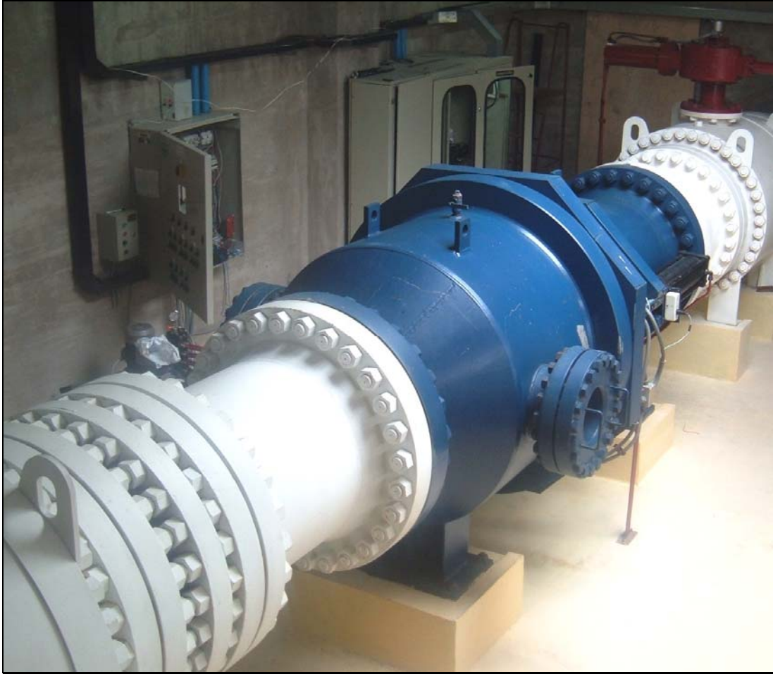
Figura. 1.8. Estación Reguladora de Presión “La Moca” (ERP)
