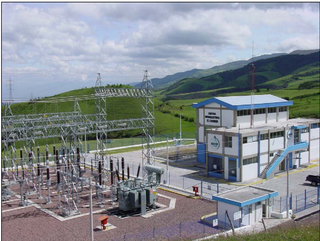
Figura. 1.6. Central Hidroeléctrica El Carmen (CHC)
