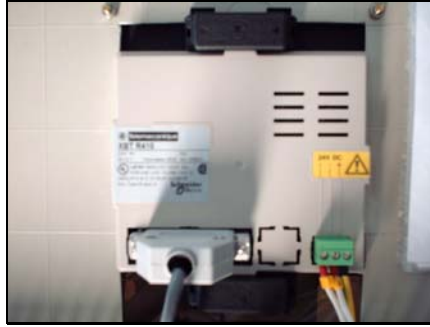
Figura. 5.15 Conexión de Magelis a PLC
