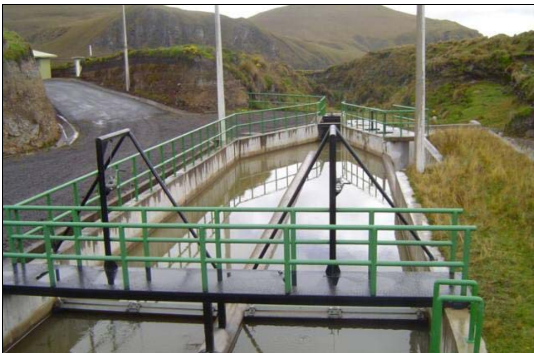
Figura. 1.4. Captación del Río Antisana
