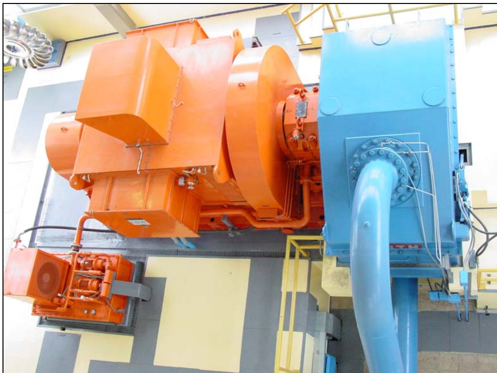
Figura. 1.5. Turbina y Generador Síncrono
