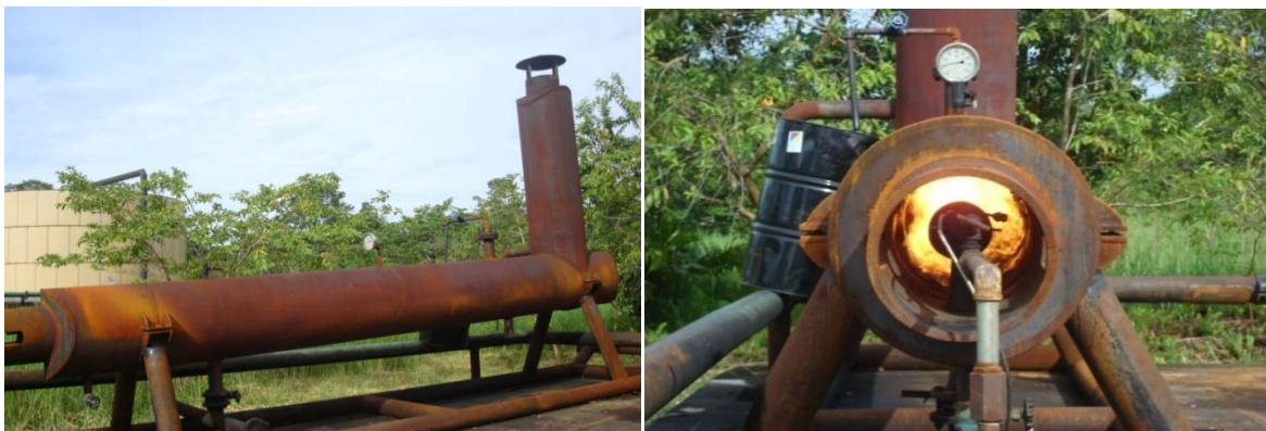
Figura 3.3: Calentador actual instalado en la estación de Cuyabeno
