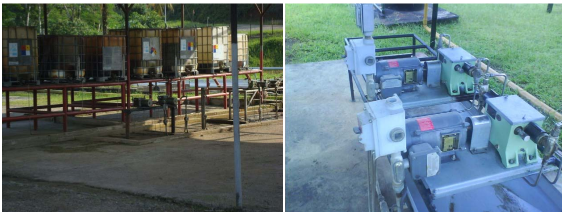
Figura 3.4: Sistema de Inyección de Químicos
