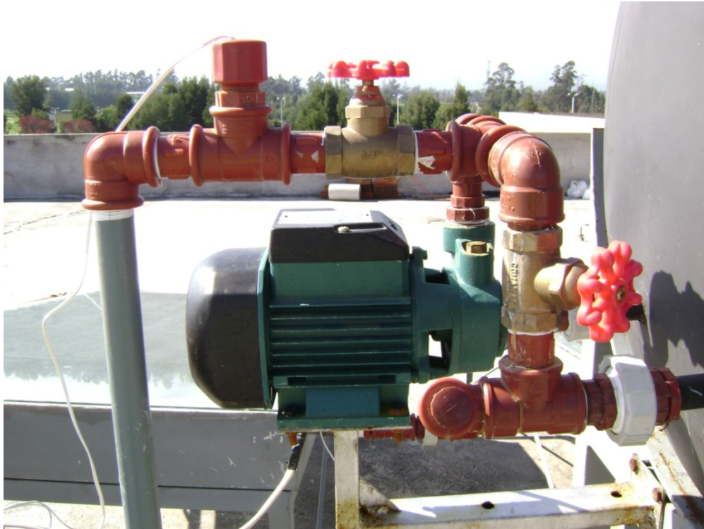
Fotografía 5: Bomba de Agua y sistema bypass
