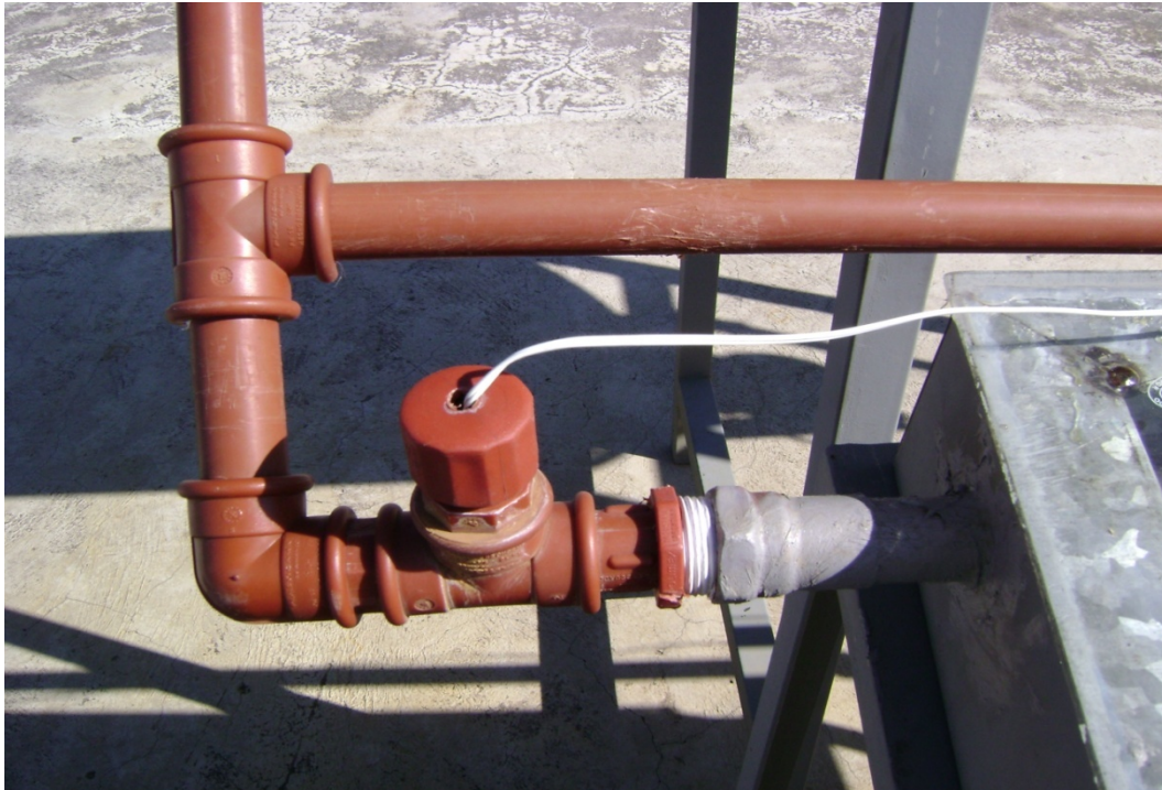
Fotografía 9: Ubicación de los Medidores de Temperatura
