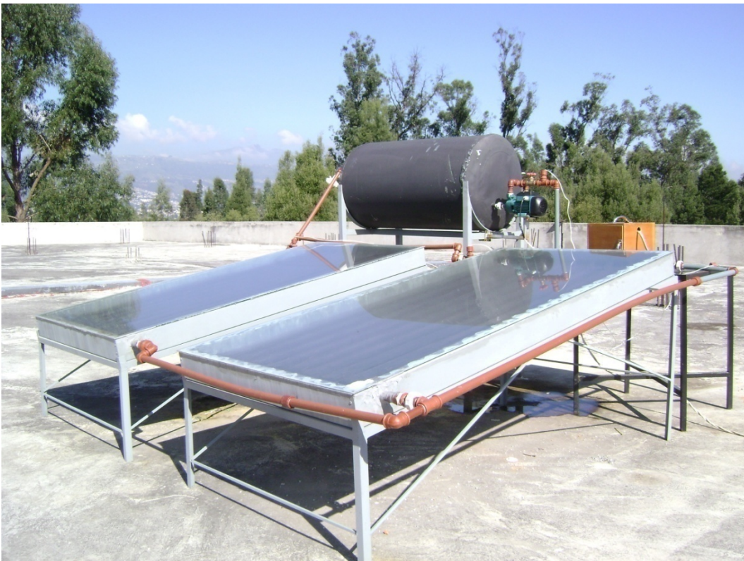
Fotografía 10: Sistema Térmico e Hidráulico
