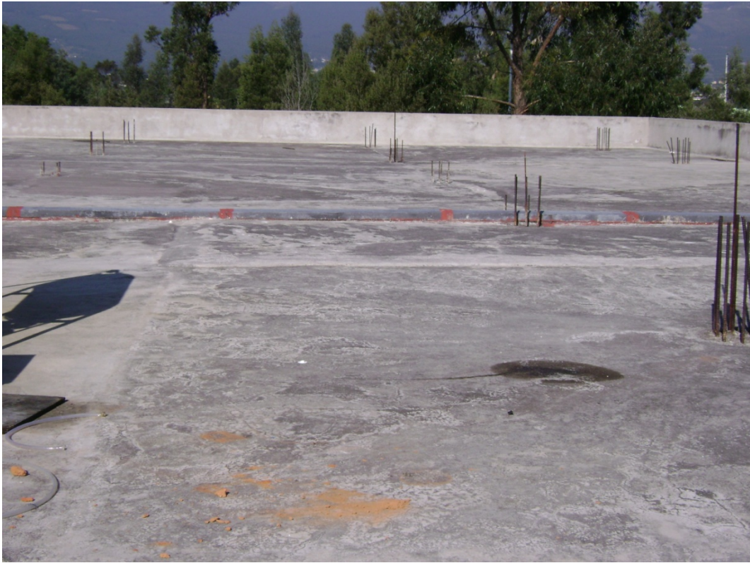
Fotografía 3: Ubicación de los Colectores Solares y Tanque Térmico
