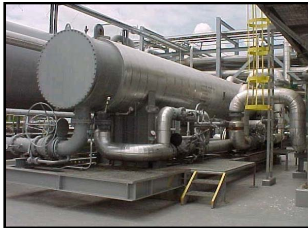
Fig. 2.11 Fotografía Intercambiador de calor
