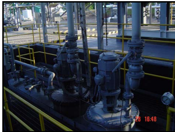
Fig. 3.20 Fotografía Vessel de Drenaje Cerrado
