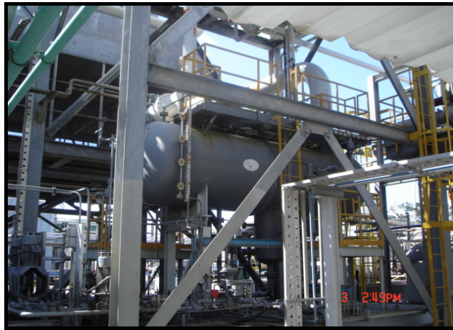
Fig. 3.15 Fotografía Separador de recobro de gas
