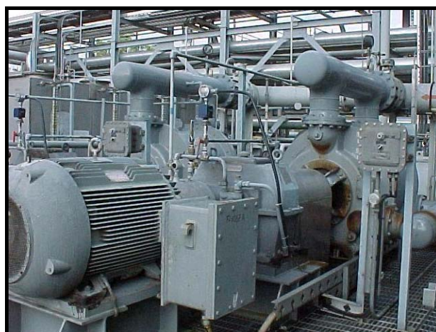
Fig. 3.13 Fotografía Unidad de Compresión
