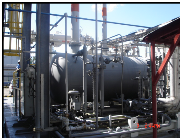
Fig. 3.16 Fotografía Separador de agua
