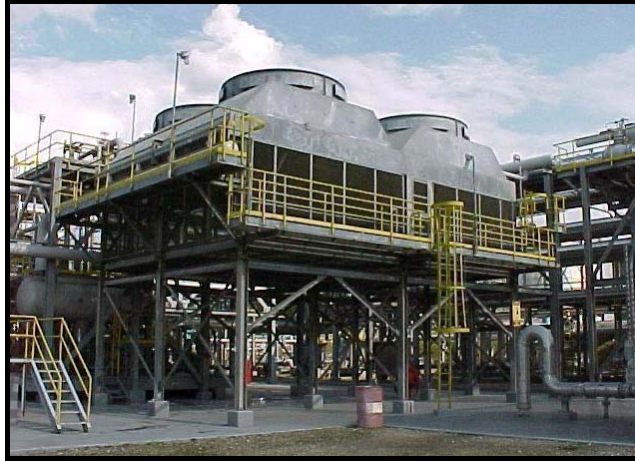
Fig. 3.14 Fotografía Enfriador de gas por aire
