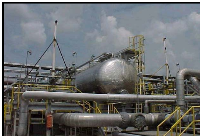
Fig. 2.21 Fotografía Scrubber de agua
