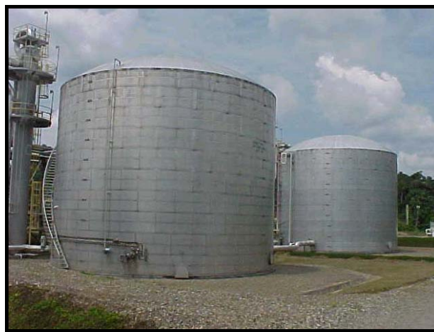
Fig. 3.18 Fotografía Tanques de almacenamiento de Crudo
