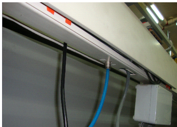
Figura. 8.4. Toma neumática del sistema.
