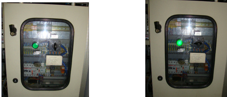
Figura. 8.5. Encendido del Sistema HYD-2800.
