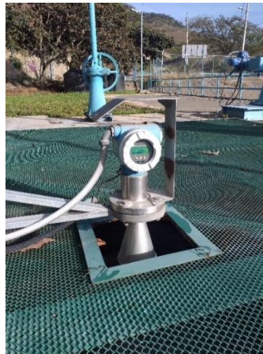
Tanque de Cabeza Central Hidroeléctrica Nayón
