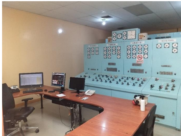
Nota. Imagen tomada en la Central Hidroeléctrica Nayón
