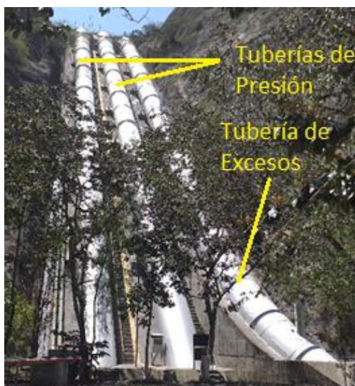
Tuberías de presión Central Hidroeléctrica Nayón
