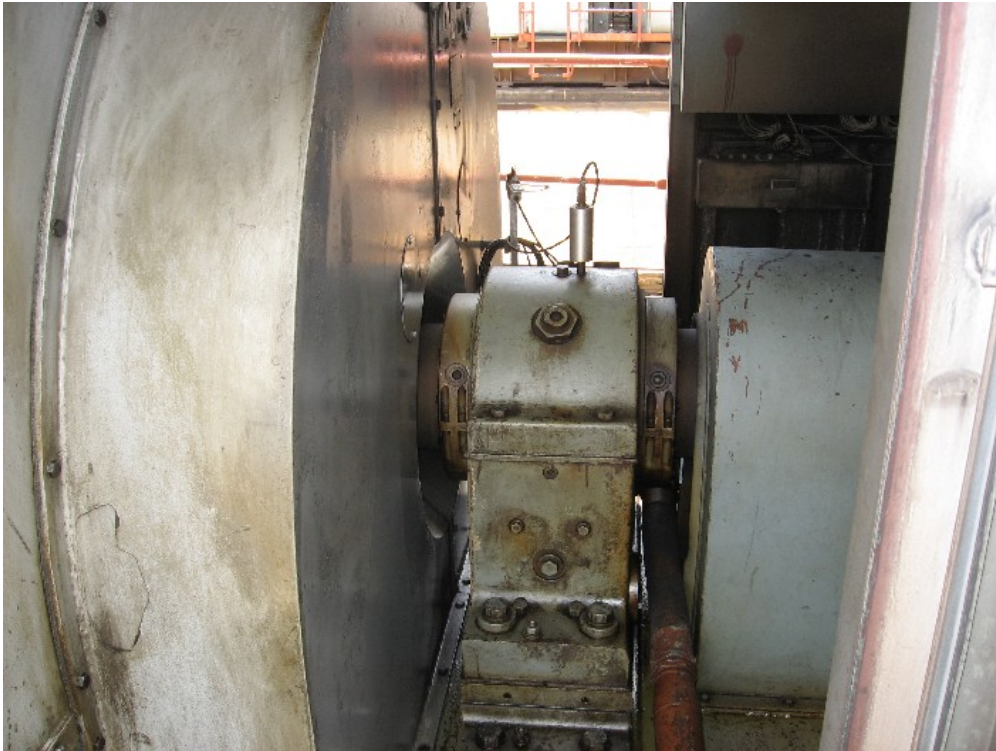
Figura 3.5 Compartimiento de caja reductora
