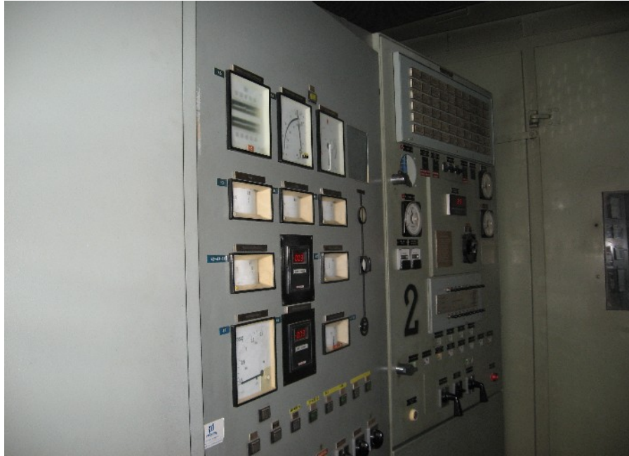
Figura 3.2 Compartimiento de control
