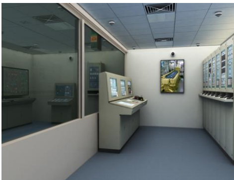
Cuarto de Máquinas
