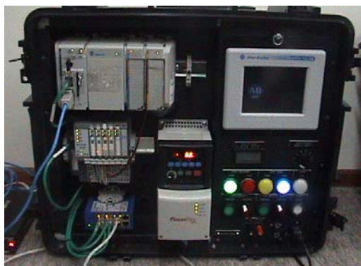
Figura. 5.22. Maleta de Pruebas Tablero Princial
