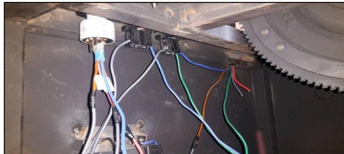
Figura No. 54. Conexión del relé y el switch
