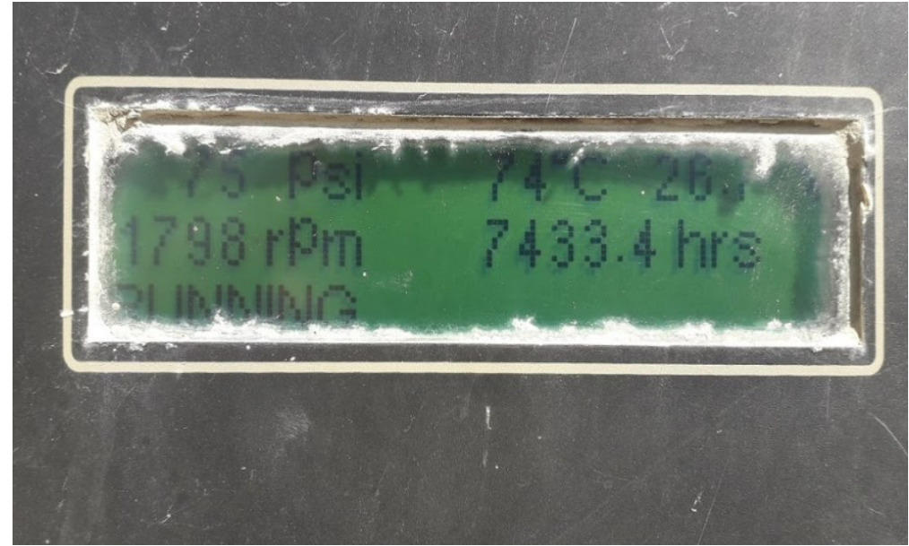
Horas de trabajo del grupo electrógeno
