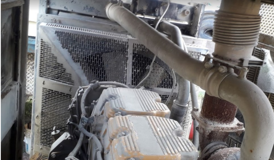
Sistema de ventilación en malas condiciones
