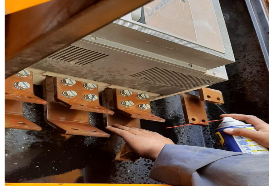
Revisión y remoción de oxido de salidas de corriente
