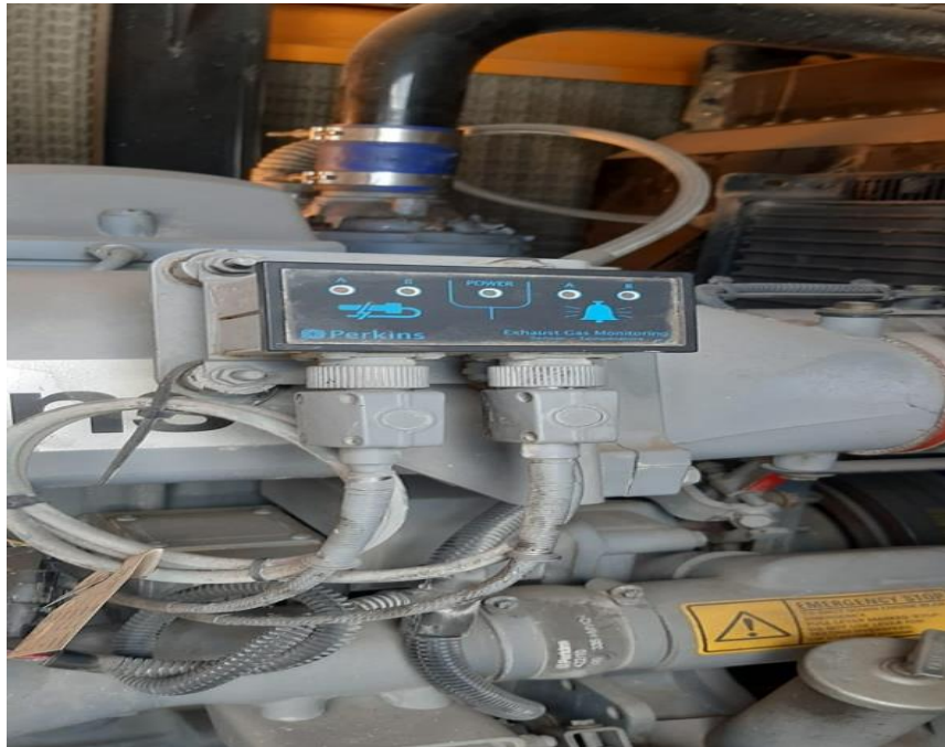
Sensor de temperatura y corte, mal estado
