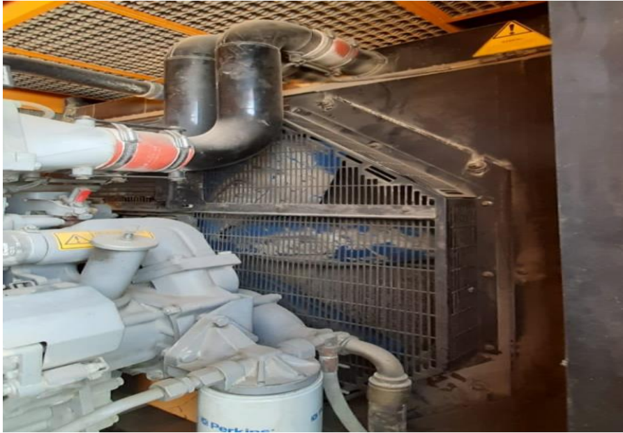
Sistema de ventilación obstruido
