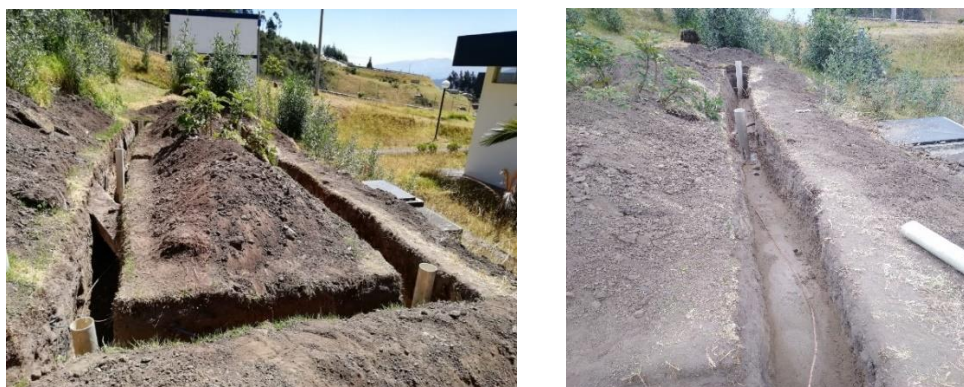
Figura 118. Pozos de revisión en MTCI
