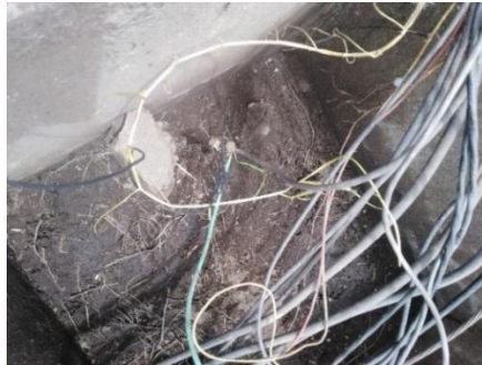
Figura 79. Pozo de revisión eléctrico
