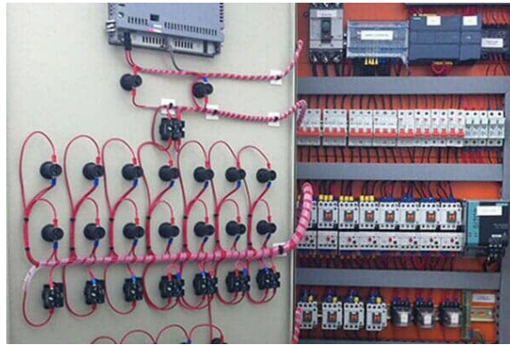
Figura 3. Ejemplo de un tablero de comando o control.
