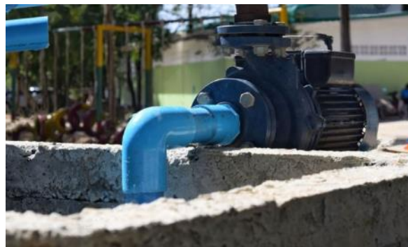
Figura 23. Bomba centrífuga en Uso
