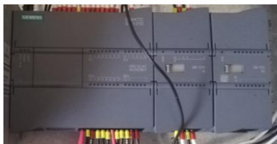
Figura 39. PLC SIEMENS S7-1200
