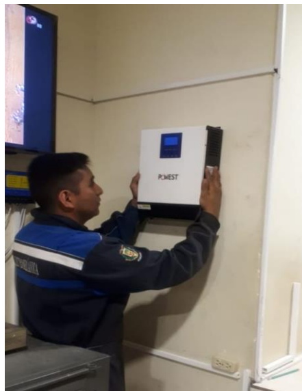
Figura 35. Instalación del UPS (Inversor, controlador de carga, ATS)
