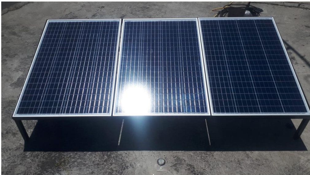
Figura 33. Orientación de los paneles fotovoltaicos
