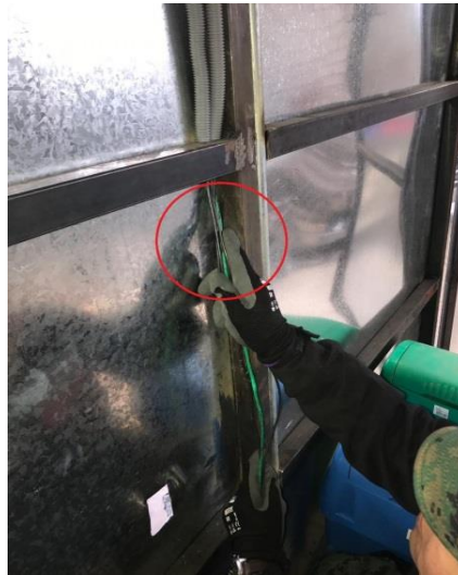
Figura 37 Cableado a tierra
