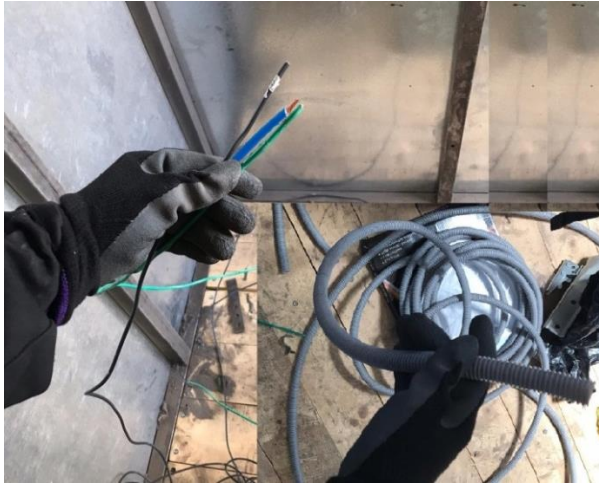
Figura 32 Paso de cableado eléctrico
