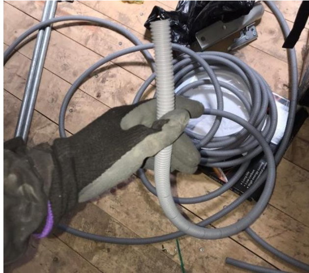
Figura 25 Tubería tipo acordeón de ½”
