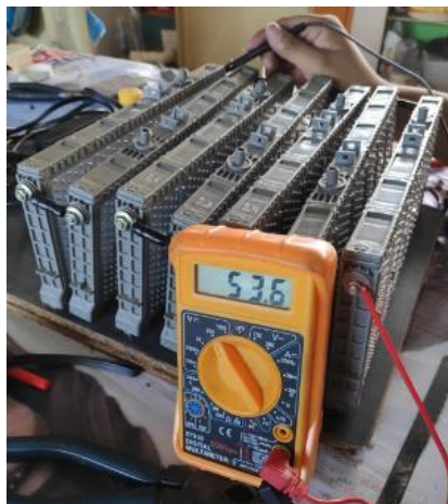
Figura 55. Conexión de celdas
