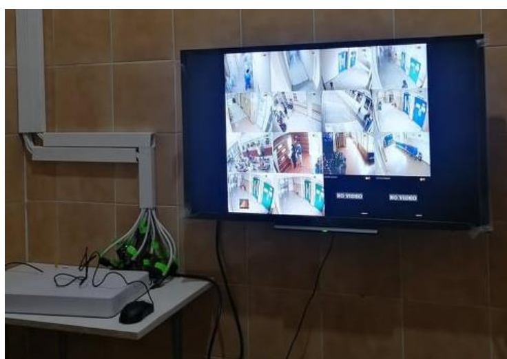
Figura 61. Funcionamiento del sistema de monitoreo
