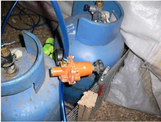
g) Centralina de gas
