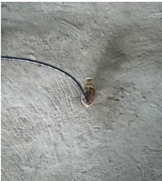
(a) Puesta a tierra de potencia
