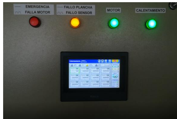
(b) Alarma fallo de plancha.
