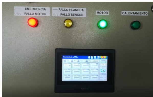
(a) Alarma paro de emergencia.
