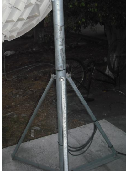
Figura 2.13 Trípode de la antena VSAT del Sistema Satelital Vsat de la Fuerza Aérea Ecuatoriana
