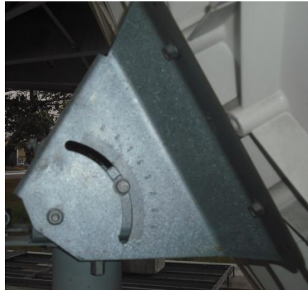
Figura 2.15 Parte lateral de la montura para la regulación de la antenna VSAT del Sistema Satelital Vsat de la Fuerza Aérea Ecuatoriana
