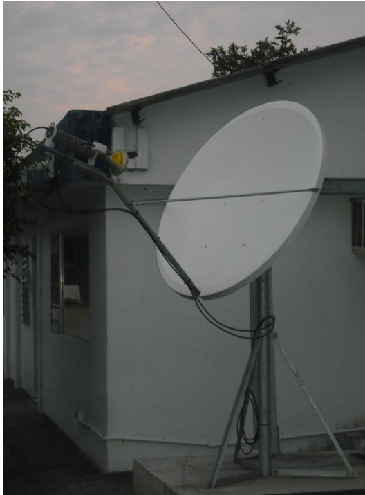
Figura 2.20 Antena instalada con sus partes del Sistema Satelital Vsat de la Fuerza Aérea Ecuatoriana
