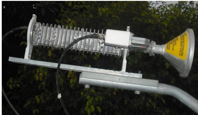
Figura 2.17 ODU de la antena VSAT del Sistema Satelital Vsat de la Fuerza Aérea Ecuatoriana
