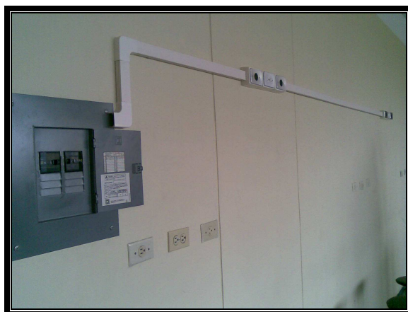
Foto 6.36: Distribución de la acometida eléctrica Fuente: Laboratorio de Control Industrial Realizado por: Cbos. Sánchez Luis
