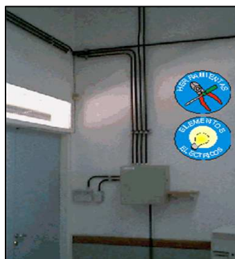
Fig. 3.5: Instalación eléctrica tipo exterior.
