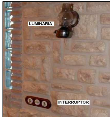
Fig. 3.4: Instalación eléctrica tipo embutida.
