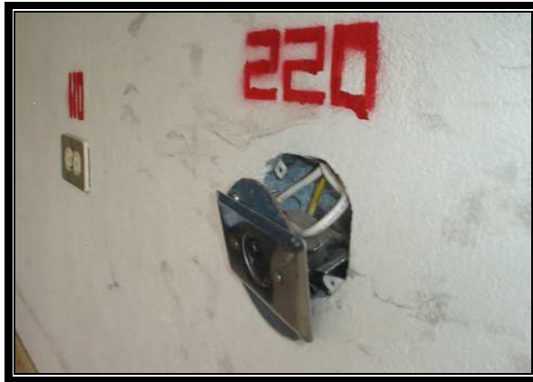
Foto 6.3: Conexiones eléctricas en mal estado Fuente: Laboratorio de Control Industrial Realizado por: Cbos. Sánchez Luis
