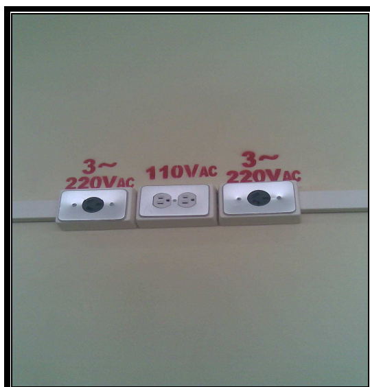
Foto 6.37: Señalización de Tomas Eléctricas Fuente: Laboratorio de Control Industrial Realizado por: Cbos. Sánchez Luis
