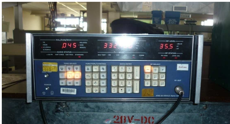
Fotografía 3.15 Generador de Señal Glide Slope
