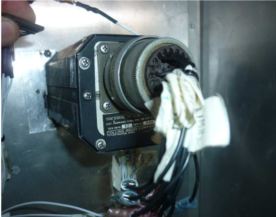
Fotografía 3.6 Instalación del Control VHF 313-4D en el Banco Didactico 1
