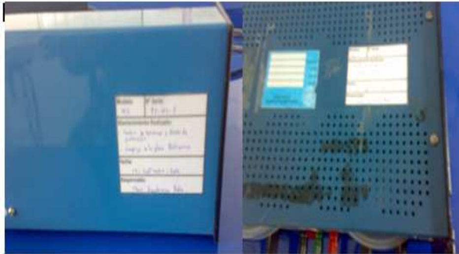
Fotografía 1. Colocación de fichas de mantenimiento.
