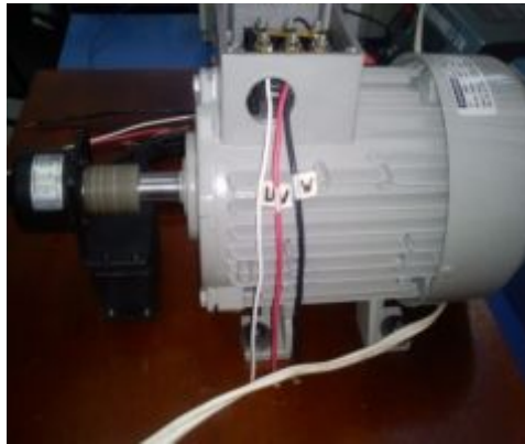
Foto 5. Encoder Incremental acoplado al eje del motor trifásico
