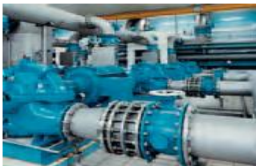
Figura 7: Control de motores.
