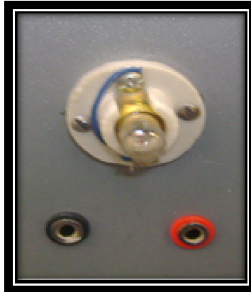
Fig. 6.17 Foco de 12VDC (Carga).
