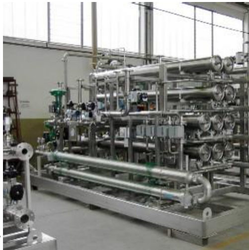
Figura 2.7: Tratamiento de aguas residuales 7
