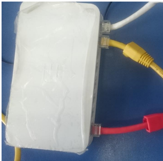
Figura 30 Cableado finalizado de la comunicación Ethernet.
