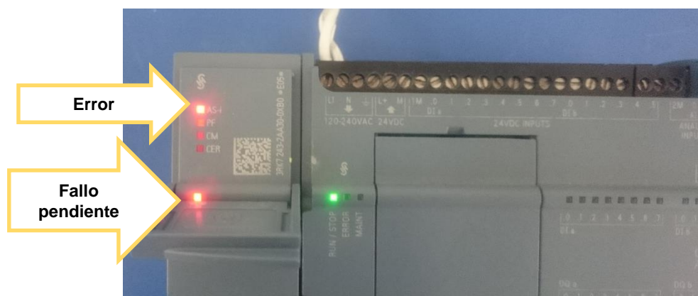
Figura 19 Conectado el PLC a la alimentación.
